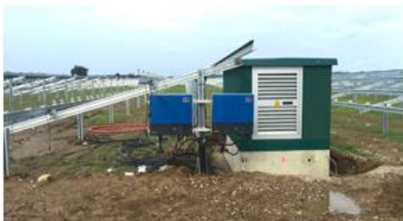
Eksempel på invertere (blå) og step-up transformere (power transformer)
