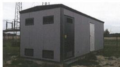
Eksempel på teknikbygning ved transformerstation
