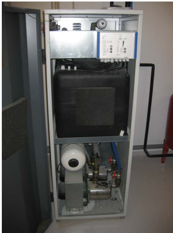
Figur 5 Styringsystemet i teknikrummet
