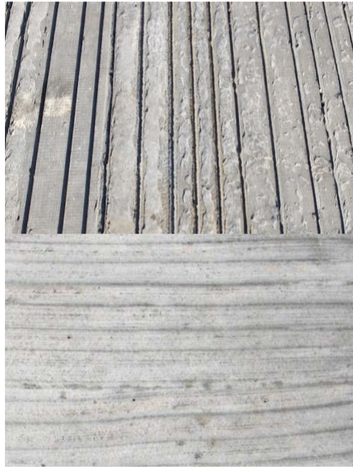
Kvæsthusmolen, København. Revet betonoverflader - råhed.
