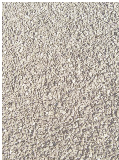
Grusbelægning, fast hårdt og homogent.
