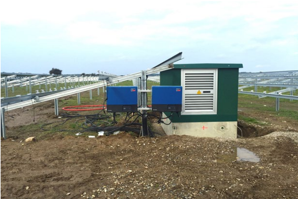
Invertere (blå) og step-up transformere i anlægget
